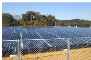
③長崎県波佐見町発電所(400Kw)
