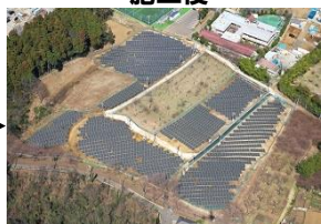
①神奈川県横浜市発電所(1.2Mw)
